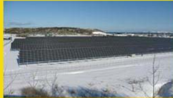
Mega solar (Wakkanai, Hokuto))
