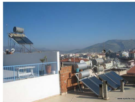
Solar thermal & Solar PV
