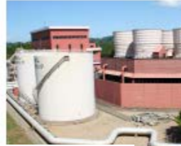
福島県地熱発電所
