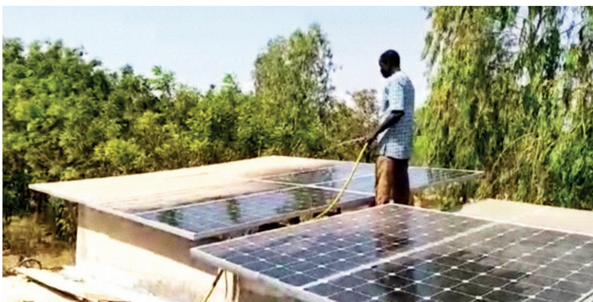
Maintenance du système solaire à la Clinique Wolobougou, près de Bobo-Dioulasso, au Burkina Faso.
